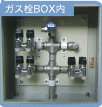
ガス栓BOX内 ヒューズガス栓6口、可とう管ガス栓
